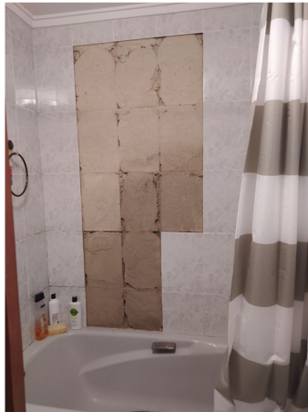
Figura 7: Escasa presencia de azulejos en el baño
